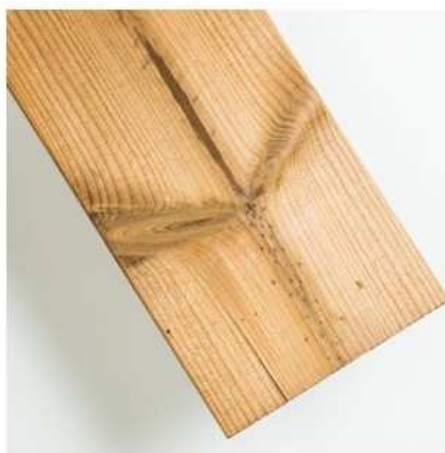
Trhliny na koncích prken jsou povoleny
