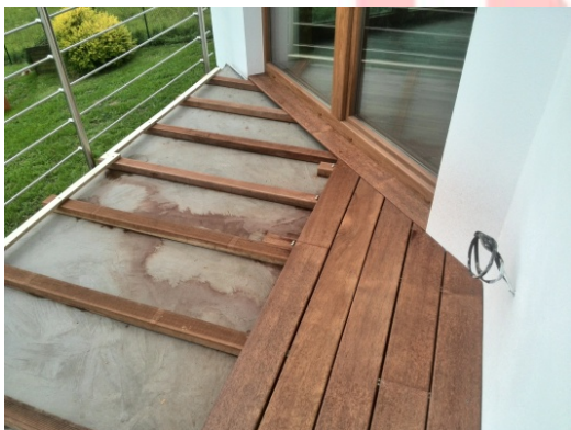
Krvácení prken MEBAU. Vyplavení barviva u prken bez povrchové úpravy.
