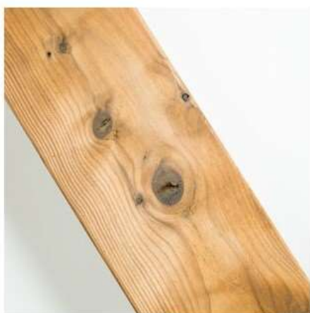
Praskliny v sucích jsou povoleny
