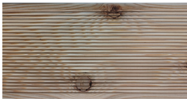
Praskliny kolem suků jsou povoleny
