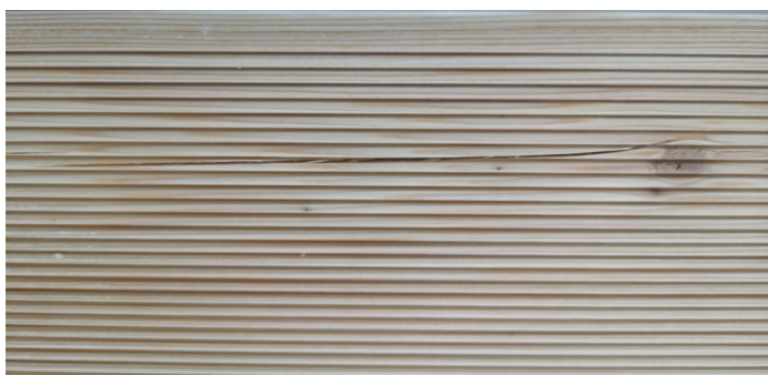
Malé praskliny na povrchu jsou povoleny
