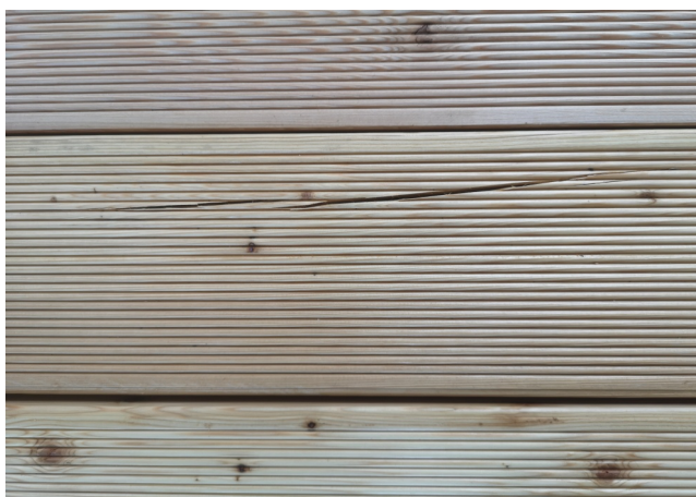
Malé praskliny na povrchu jsou povoleny
